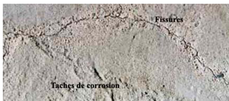
Figure 5.3 – État initial de formation des fissures à la surface du béton (ouverture \leq 0,1\text{mm} )
