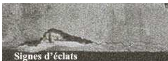
Figure 5.12 – Épaufrement du béton due à une fissuration très importante (environ 1,0 mm)
