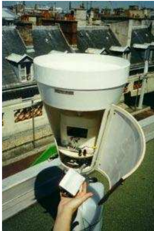
Figure I.5 : Pluviomètre à augets basculeurs disposé sur le toit de la crèche à côté de l'ARS 1000
