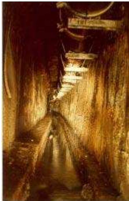
Le réseau d'assainissement de Paris (3 ème arrondissement) : collecteur Vieille du Temple (Martin S.©98)
