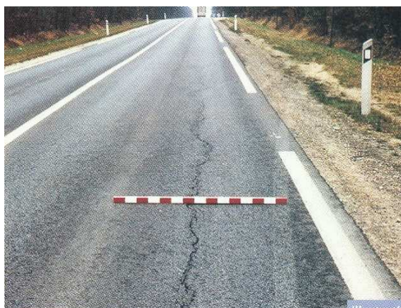
FIGURE 2.2. Fissure longitudinale dans une bande de roulement [LCPC, 1998]
