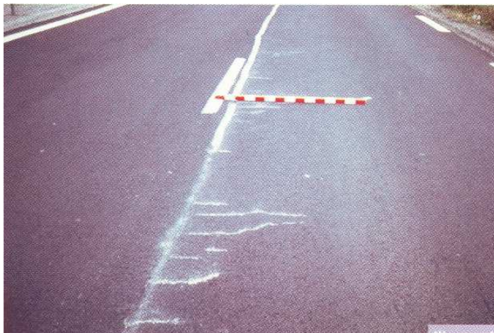
FIGURE 1.14. Remontée de fines : dégradation franche, significative et étendue [LCPC, 1998]
