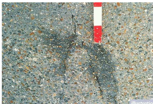
FIGURE 2.5. Fissure diverse en Y dans la chaussée en béton [LCPC, 1998]
