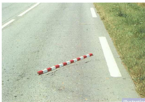
FIGURE 2.8. Fissure oblique de dalle [LCPC, 1998]
