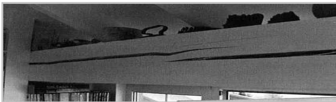
Figure 2. Fentes de surface sur une poutre dans des combles aménagés.
