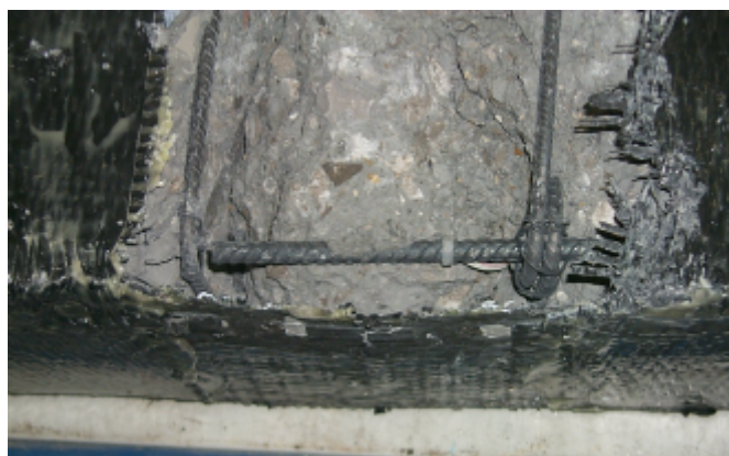
Figure II-44 Rupture en fatigue d'une armature tendue au droit d'un cadre (poutre n°23, HA8)
