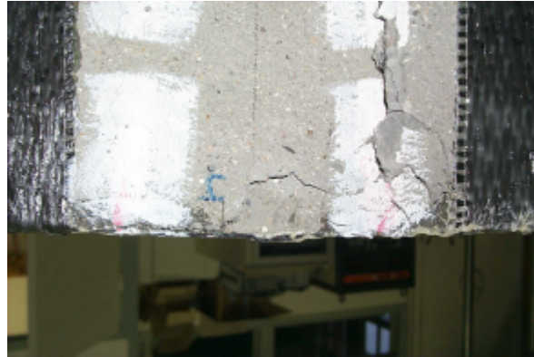
Figure II-45 Délaminage du béton d'enrobage (poutre n°23, HA8)
