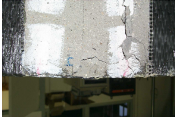
Figure II-45 Délaminage du béton d'enrobage (poutre n°23, HA8)
