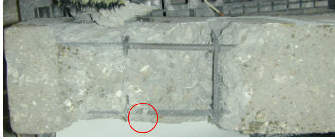
Figure II-50 Rupture en fatigue d'une armature tendue au niveau de la fissure d'effort tranchant (poutre n°16, vue de dessous, composite enlevé)
