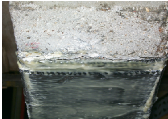
Figure II-46 Décollement à l'extrémité du TFC en surface tendue (vue dessous – poutre n°23, HA8)
