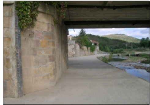
Vue actuelle de la pile rive gauche, sur laquelle l'échelle existe toujours
