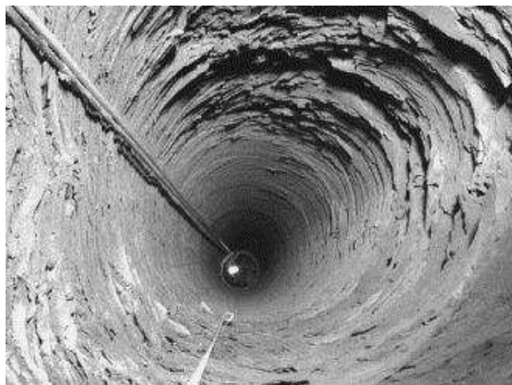
Figure 0-4a : Dégradation autour du puits après la fermeture (Derek Martin et al. 2003).
