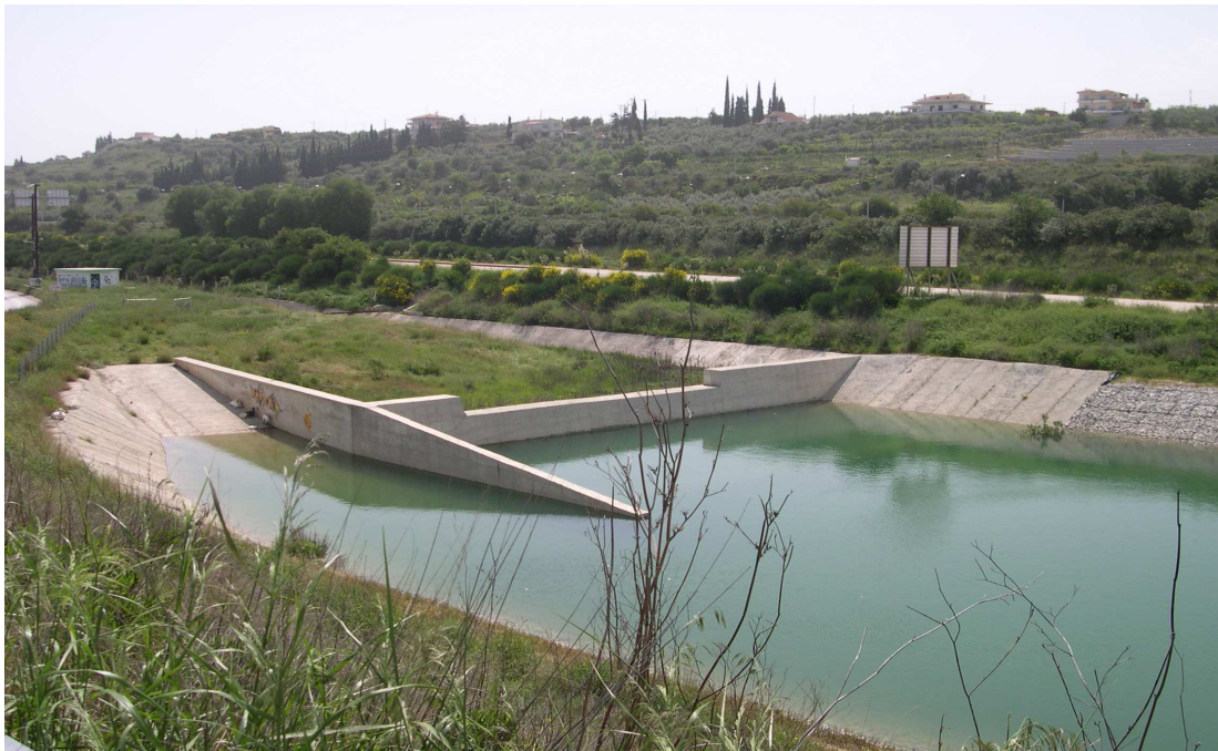
Photo 2: Bassins de décantation et infiltration près de l'autoroute Athènes Corinthe (projet de Soteropoulos Consultancy)
