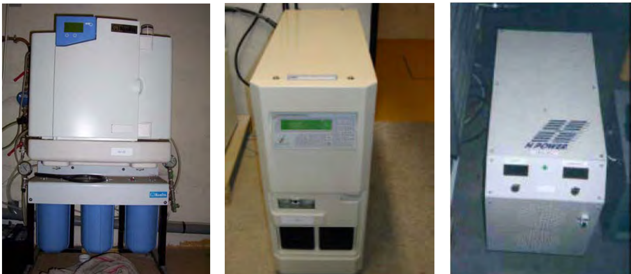
figure II. 11 : photo du déioniseur (g.), du convertisseur SMD (milieu) et du chargeur de batteries (dr.)
