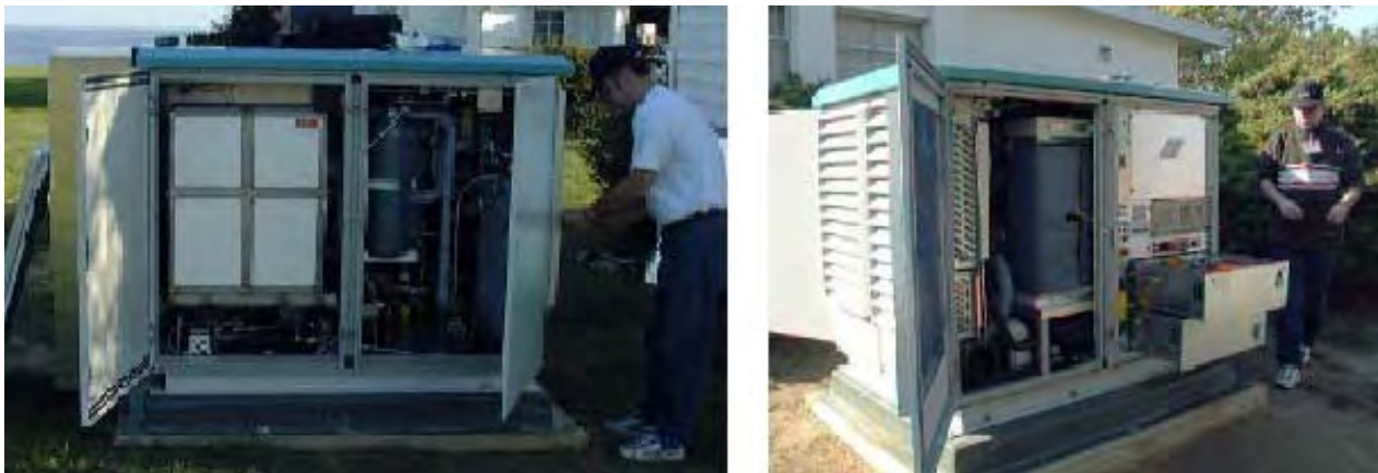
figure I. 2 : unités du RCU-4500 installées à Patuxent River
