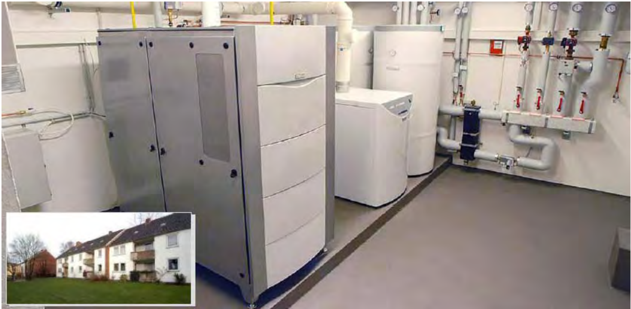
figure I. 4 : unité d'Oldenburg (Allemagne), au fond les deux ballons de stockage
