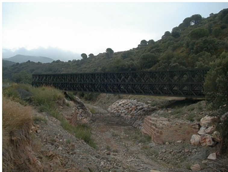
FIG. B.8 – Crue du Verdouble : pont amont sur la Donneuve vu de l'aval.
