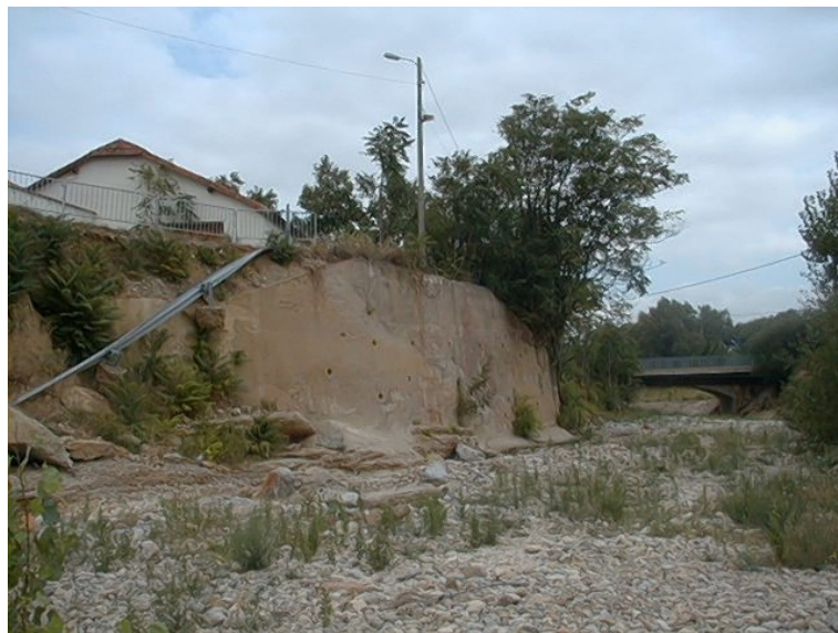
FIG. B.6 – Crue du Verdoubte : ruisseau de Coume en amont immédiat de sa confluence avec le Verdoubte à Paziols.
