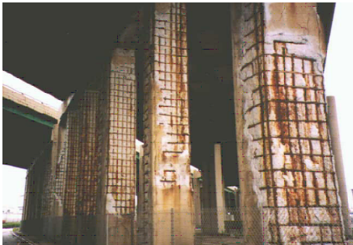
Figure 1.2: Colonnes ravagées par corrosion.
