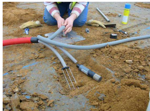
b) mise en place des différents capteurs
