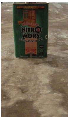
Figure 23 : le Nitromors® et auréoles de plomb provoquées par le décapage au gel
