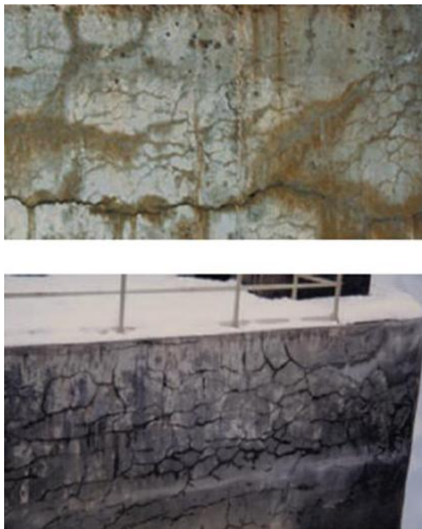
FIGURE I.3.1 – Exemples de dégradations d’ouvrages dues à l’alcali-réaction [Baroghel-Bouny 05a]
