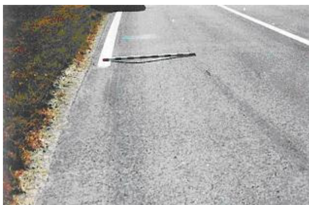
Fig. I-4 : dégradation superficielle caractéristique d'un ornierage des couches de surface (LCPC 1998)
