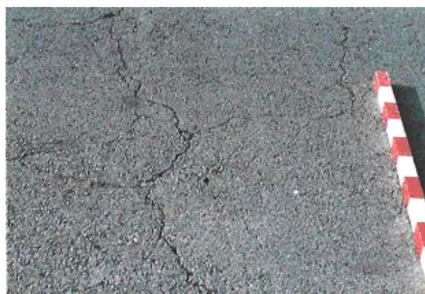
Fig. I-5 : dégradation superficielle caractéristique de la fissuration par le haut des couches de surface (LCPC 1998)
