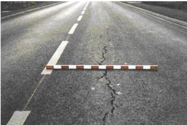
Fig. I-6 : dégradation structurelle caractéristique de l'usure des couches d'assise qui se traduit par une fissure longitudinale unique (LCPC 1998)
