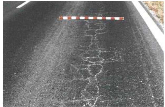
Fig. I-7 : dégradation structurelle caractéristique de l'usure des couches d'assise qui se traduit par une fissure longitudinale ramifiée (LCPC 1998)
