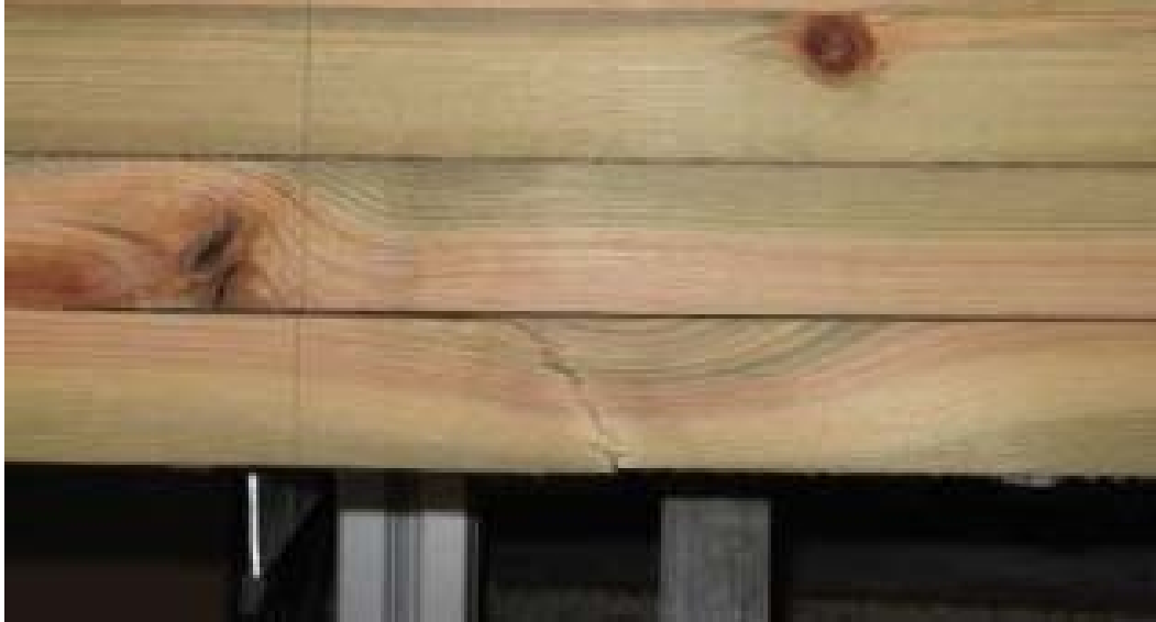
Figure 5.34. Fissure de la lame inférieure en traction
