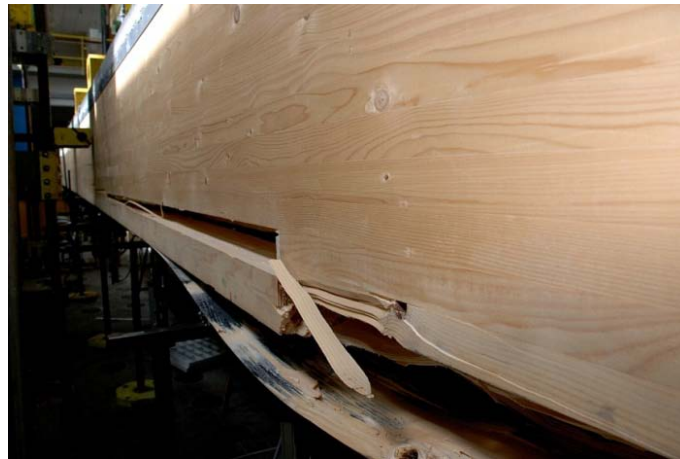
Figure 1.49. Rupture initiale au niveau d'un joint d'aboutage de la seconde poutre en bois
