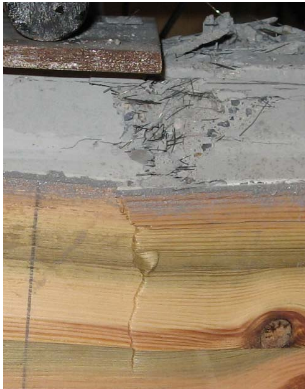
Figure 5.30. Ruine par compression du bois
