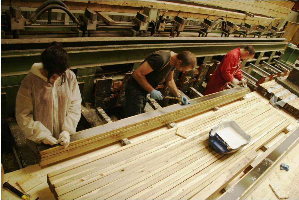
Figure 5.2. Insertion manuelle des lamelles de carbone et fixation provisoire par des clous
