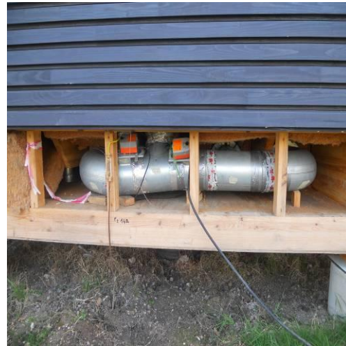
Figure 99 : vue de l'assemblage du circuit hydraulique amont
