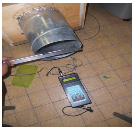
Figure 105 : Mesures des vitesses d'air à la sorti de caisson
