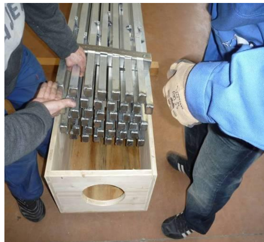
Figure 91 : Installation de l'échangeur dans le caisson
