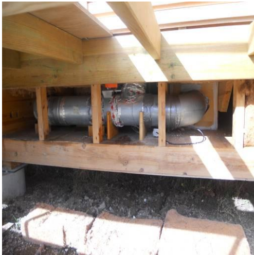
Figure 98 : vue de l'assemblage du circuit aéraulique aval
