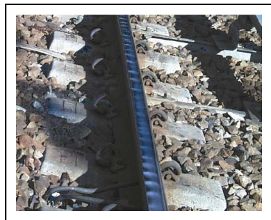
Figure 1.8 : Usure ondulatoire du rail
