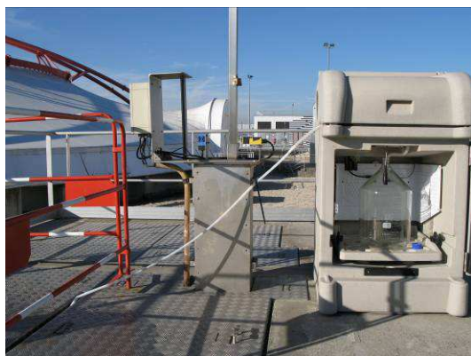
Figure 55 : Dispositif de prélèvement des eaux brutes, en amont du décanteur 5 sur Seine-Amont
