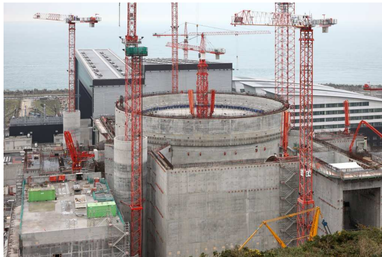
FIGURE 1.4 – Enceinte de confinement de l'EPR en construction sur le site de Flamanville.
