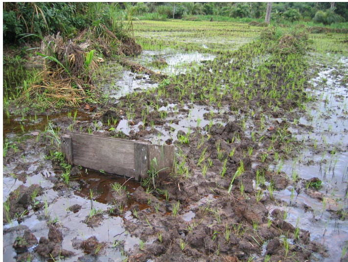
Photo 35 : Vestiges du drain central d'un aménagement du PDRI, détruit par l'agriculteur (Gbouo, 07/05)
