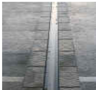
Figure 52: Rail de guidage du TVR (Source : auteur)
