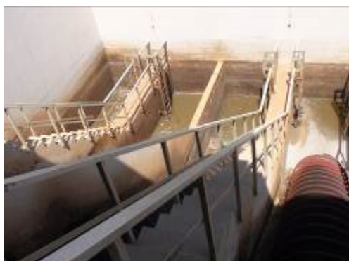
Vis de relevage des eaux usées en entrée de station
