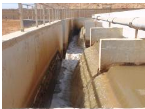
Eau traitée avant rejet en mer
