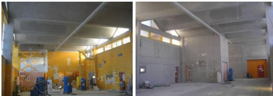
Figure 10 : Atelier B pendant les opérations d'assainissement (à gauche) et à l'issue des travaux (à droite).
