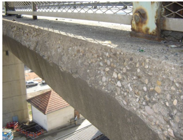
Figure 1.29 Béton de corniche peu résistant à l'écaillage
