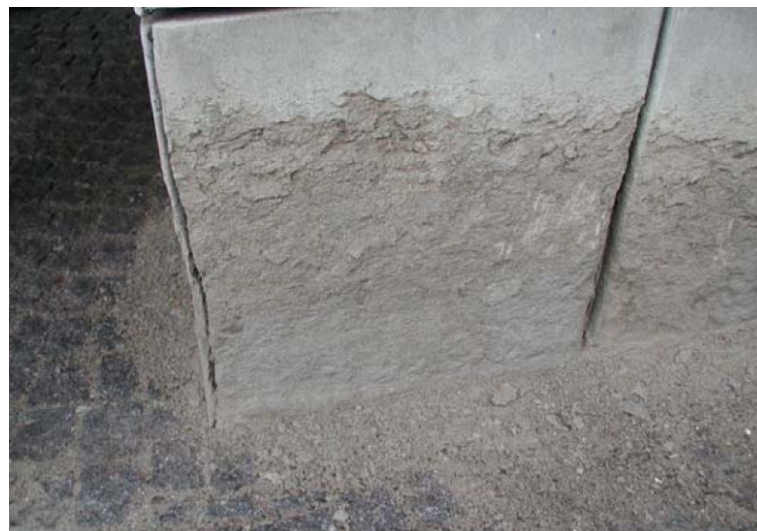
Figure 1.50 Roche calcaire poreuse présentant un degré de saturation supérieur à 95% et une forte détérioration au gel-dégel (fissures et écaillage) – façade d'immeuble, Copenhague, Danemark d'après [I-Stone, 2006]
