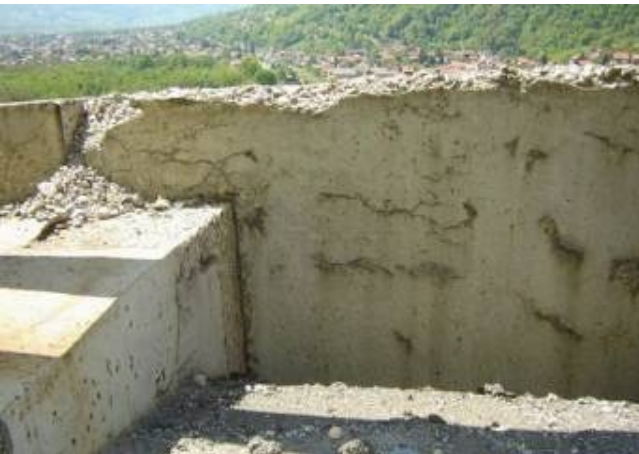
Figure 1.28 Muret en béton dégradé par gel interne
