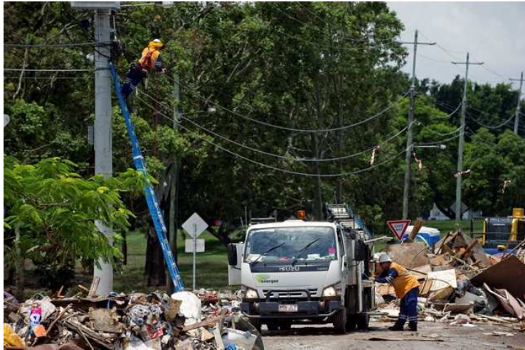
Photo 6 : Remise en état du réseau d’électricité en Australie suite aux inondations de janvier 2011 (Agence Reuters, 2011)
