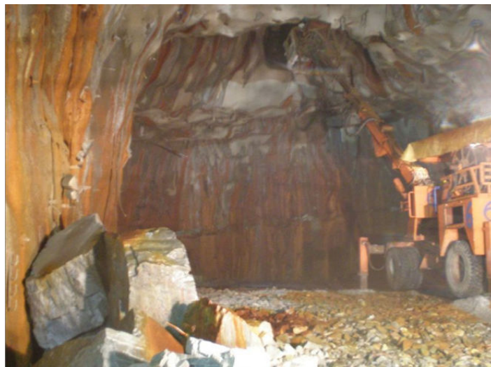
FIGURE IV.30 – Photo de la zone où a eu lieu la chute de blocs
