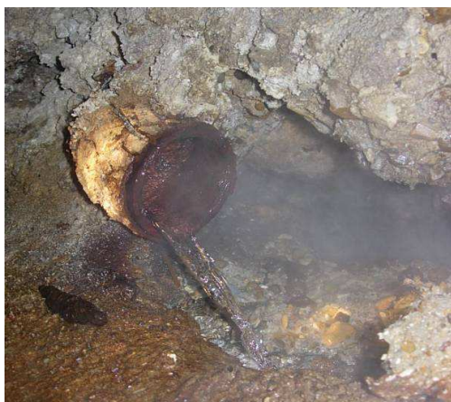
Annexe 1. 42 : Fuite du réseau de Chauffage urbain (photo IGC).
