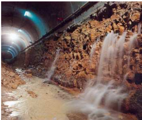
Figure 1. 80: Construction de la ligne 14 traversant la nappe du Lutétien sous la place Lachambeaudie (photo : RATP).
