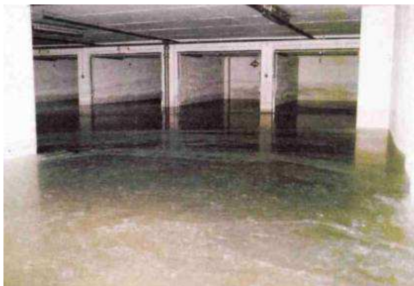
Figure 1. 53: Inondation d'un parking de la rue Bergère (Paris 9e) par remontée de nappe en 1975 (photo : G. BERGER).
