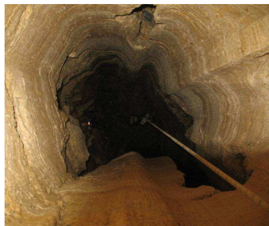
Annexe 1. 43: Vide résultant d'une fuite du réseau de chauffage urbain (photo IGC).
