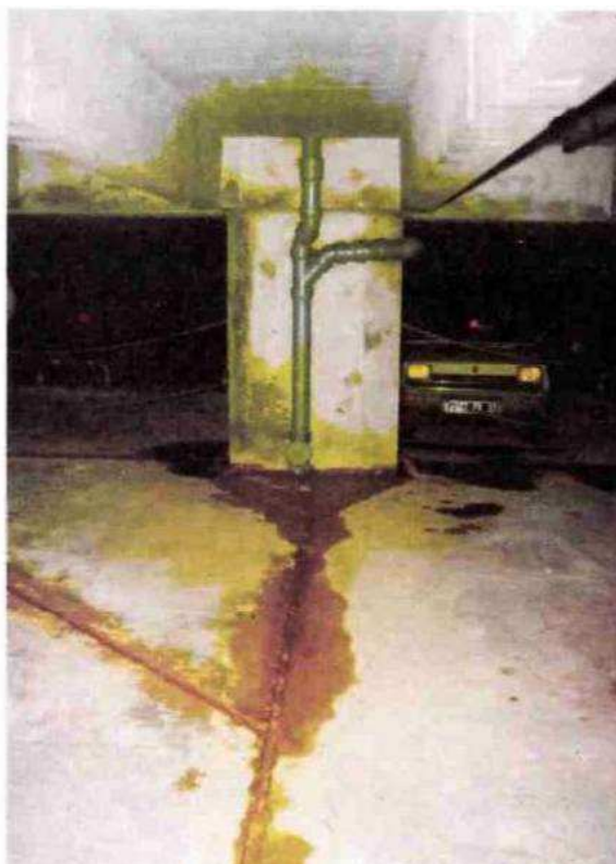
Figure 1. 102: Venues d'eau sous la place de la Madeleine résultant d'une remontée des nappes en 1975 (Bergeron et al. 1983).
