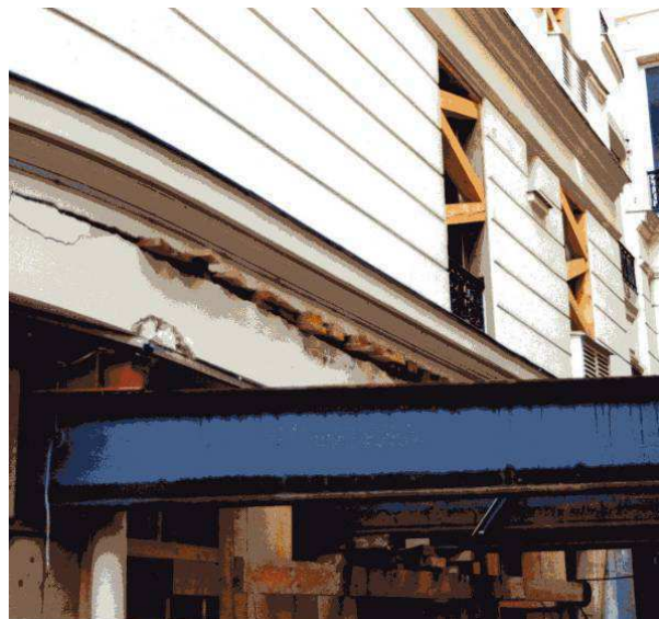
Figure 1. 97: Destruction d'habitation causée par une poche de dissolution le gypse antéludien rue Papillon, 9e arrondissement (photo: IGC).
