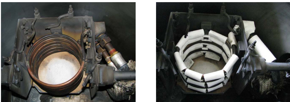
Figure 21: Bobinage électromagnétique sans isolant (à gauche). Avant une coulée, du feutre d'alumine est inséré entre chaque paire tube de cuivre (à droite).
