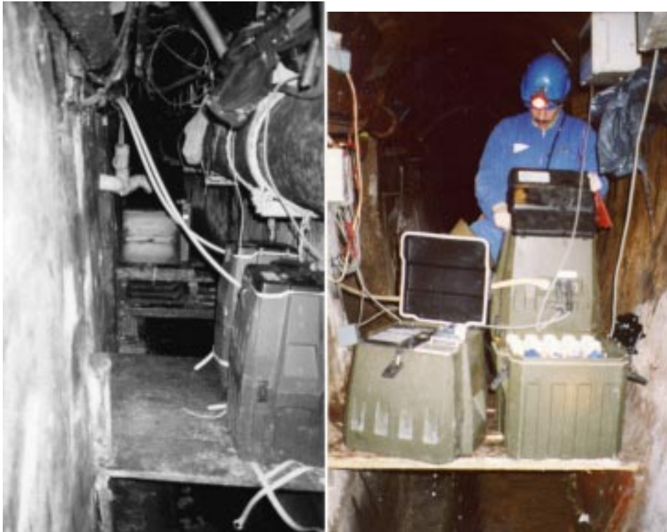
Avaloir «Vieille du Temple », drainant les rues Rosiers et Marché des Blancs Manteaux
