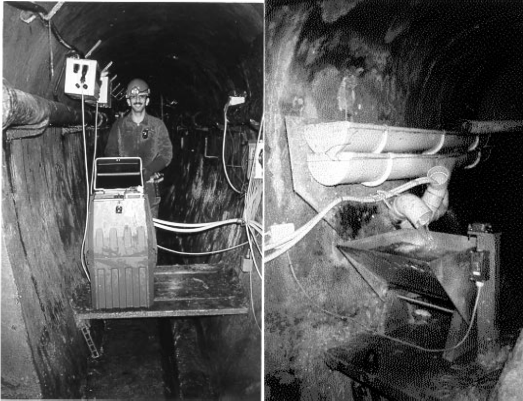
Canalisation des eaux de ruissellement, mesure du débit et prélèvement, avaloir «Duval », drainant les rues Duval et Roi de Sicile
