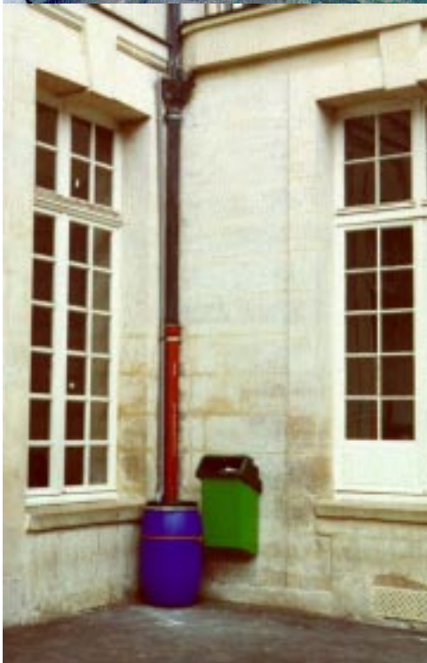
Collecte des eaux de ruissellement, toiture Ardoise 1
