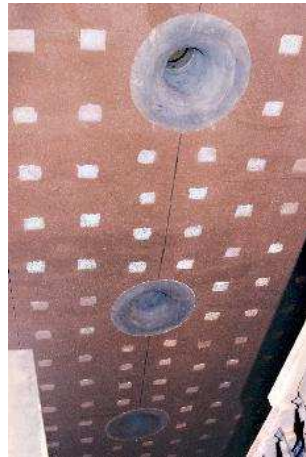
Figure 1.3 – Brûleurs de voûte.
