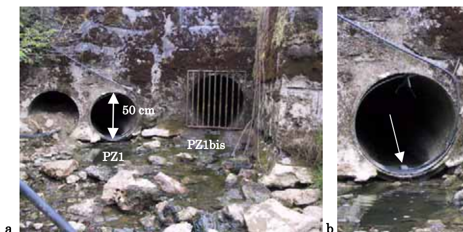
Planche 3 : vues du collecteur "PZ1" (deuxième en partant de la gauche), depuis le fond du fossé, dos tourné vers l'aval. Le collecteur visible à sa gauche est entièrement bouché et ne rejette rien. Le deuxième collecteur actif "PZ1bis", muni d'une grille, est visible à sa droite. Sur l'agrandissement de droite (b), on distingue la sonde de mesure de vitesse et de pression au bas du collecteur (voir 2.1.2), sous la flèche.
