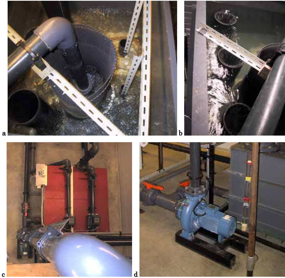
Planche 9 : vues du circuit de recirculation. (a) démarrage du remplissage du bac surélevé ; on distingue au milieu la canalisation d'alimentation et la grille de tranquillisation, à droite les deux départs des conduites d'alimentation (b) détail des colonnes déversantes en cours de fonctionnement (c) pompe de recirculation en vue plongeante bas depuis le bac surélevé, dans l'axe de la conduite qui l'alimente ; on distingue à gauche le T et les vannes des canalisations d'aspiration, à droite les portions horizontales, vannes et compteurs des canalisations d'alimentation (d) pompe de recirculation, niveau de contrôle du bac au sol (tube relié au bac, contenant une balle plastique)
