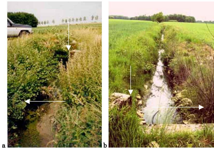
Planche 5 : vue du débouché du collecteur "PZ1" , (a) avant, vu depuis l'aval et (b) après le réaménagement du fossé, vu depuis l'amont ; le coin de maçonnerie visible sur les deux photos (flèches blanches verticales) permet de se repérer, l'arbuste visible sur la photo de droite est en feuilles sur la photo de gauche, sa base y est alors au niveau du fond du fossé (flèches blanches horizontales).
