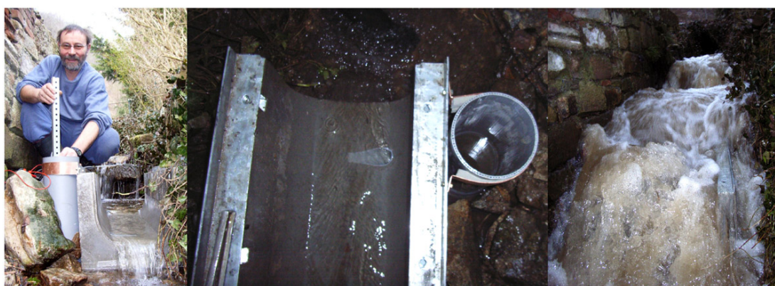
FIG. C.26 – De gauche à droite : Thierry installé sur le limnimètre installé, zoom sur la canalisation et la chambre de tranquilisation et débit lors d'une crue éclair.
