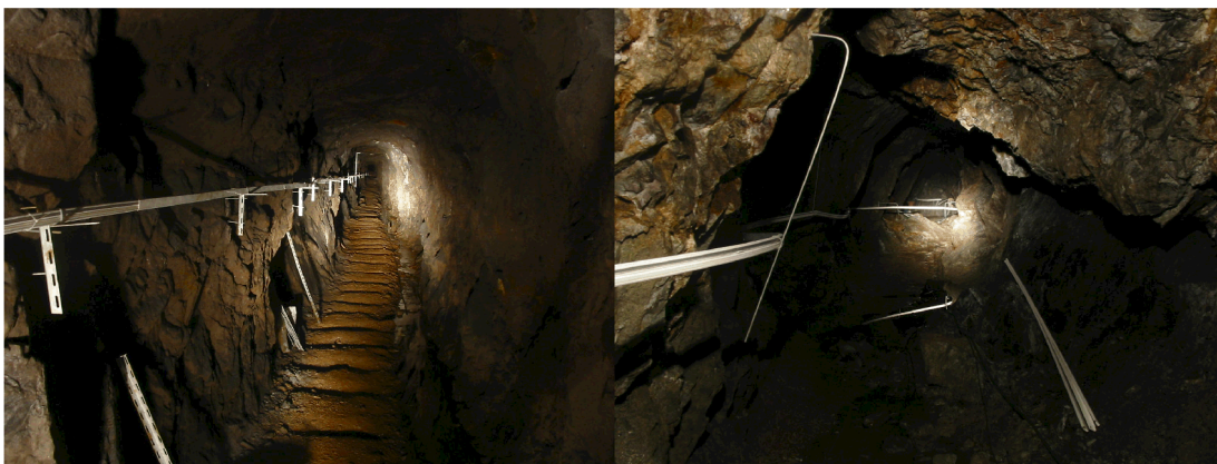
FIG. C.11 – Photo des deux inclinomètres installés. A gauche, l'instrument orienté N37°E installé dans un travers banc. A droite, l'instrument orienté N120°E, installé dans le filon exploité, instable. A noter la nécessité de s'adapter aux zones d'éboulements dans cette dernière galerie.
