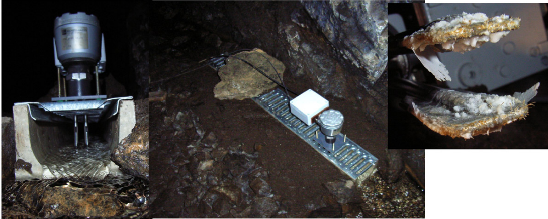
FIG. C.22 – De gauche à droite : capteur mécanique dans son environnement, canalisation du débit d'exhaure de la mine et précipitation des carbonates sur les lames vibrantes lors de son installation en chambre de tranquillisation.
