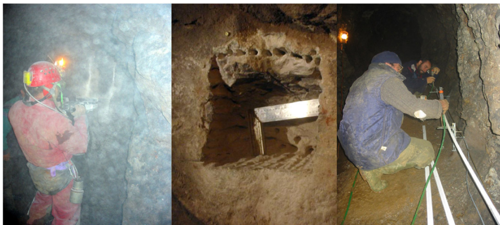
FIG. C.8 – De gauche à droite : Délimitation de la position de la niche Sud à l'aide d'une disquetteuse Diamant, par Michel Kammenthaler. Niche sud percée, a noter les trous de pré-perçage. Frédéric Boudin et Claude Courteil vérifiant l'horizontalité entre 2 équerres successives.
