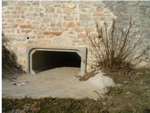
FIG. 2.19 – Buse à l'origine d'une submersion
