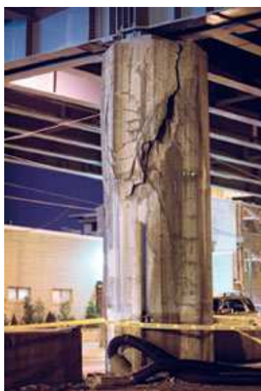
(a) Constatation des dommages
