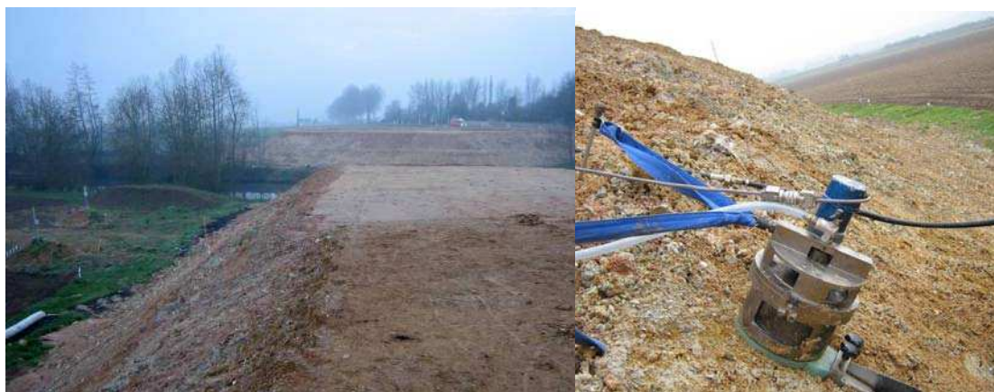
Figure 3.16 : Photo du remblai prise sur sa crête et un essai en cours sur le talus
