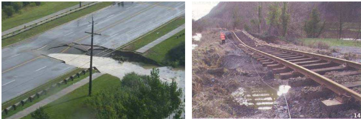
Figure 1: Illustration de la conséquence de l'érosion interne sur des infrastructures linéaires (Soudain, 2004)
