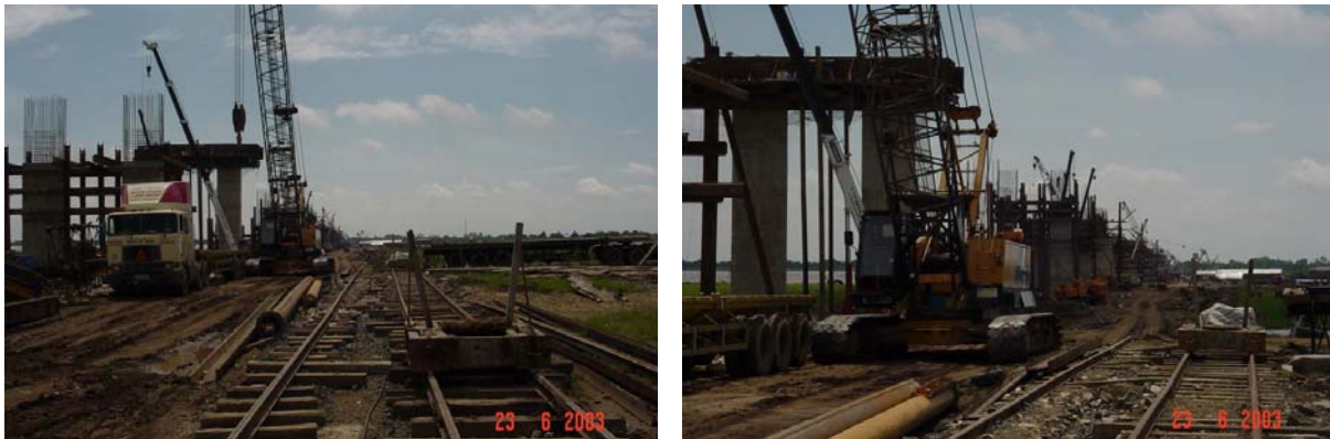
Les voies de circulation sur le chantier étaient en mauvais état et mal entretenues
