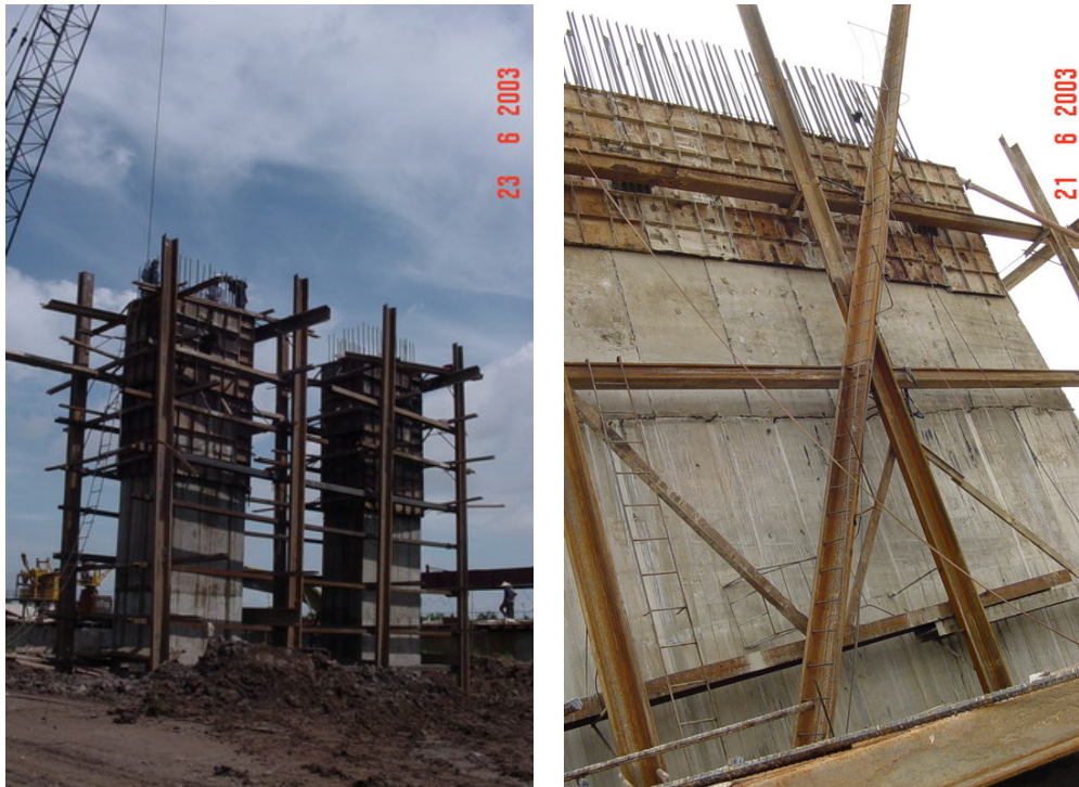
Le manque de dispositifs de sécurité sur le chantier
