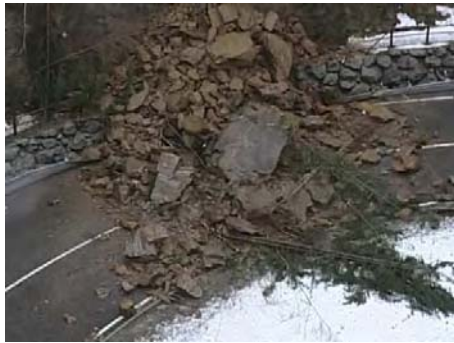
Figure 3. Route d'accès au tunnel du Mont-blanc fermée durant plusieurs jours, mars 2007.
