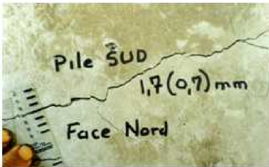
Figure 7-3 Détail d'une fissure observée sur le chevêtre de la pile sud. (Divet 2001)
