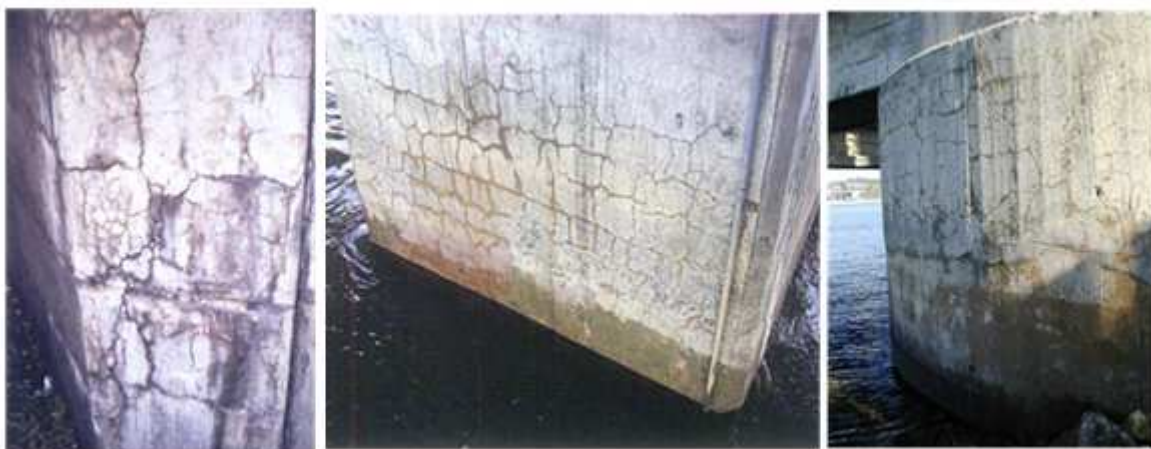
Figure 2-3 Exemple de désordre induit par la RSI sur les structures
