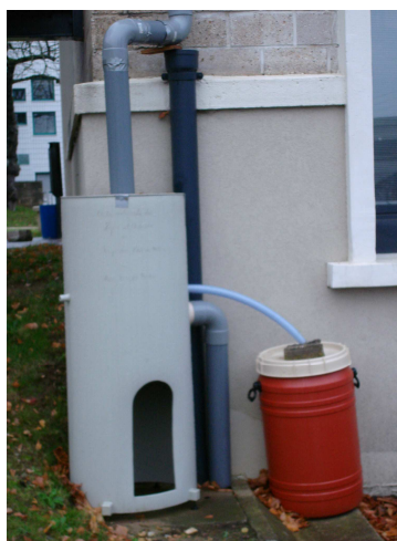
Figure 99 : Dispositif de collecte des eaux de ruissellements sur les toits réels
