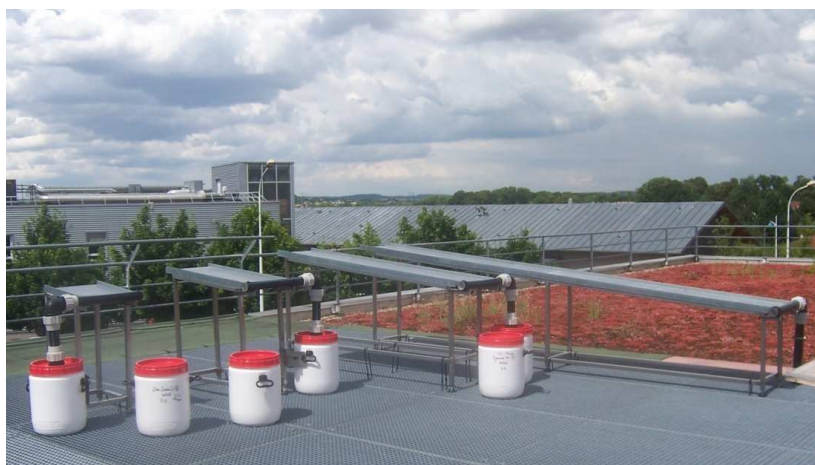
Figure 93 : Photographie du dispositif « flûte de pan »
