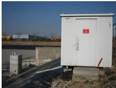
Figure 20 : Accès facilité aux appareils de mesures dans un local technique proche du point de mesure sur le site de Chassieu à Lyon (INSA de Lyon – site de l'OTHU)
