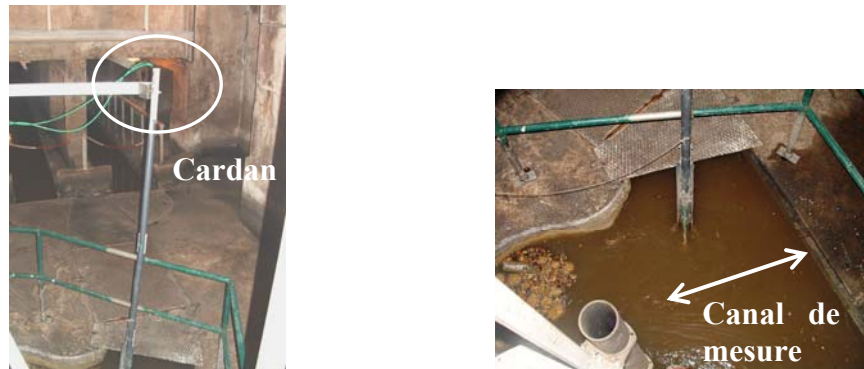
Figure 16 : Cardan assurant l'orientation des cellules optiques et le positionnement au centre du canal de mesure sur le site de Duchesse Anne à Nantes
