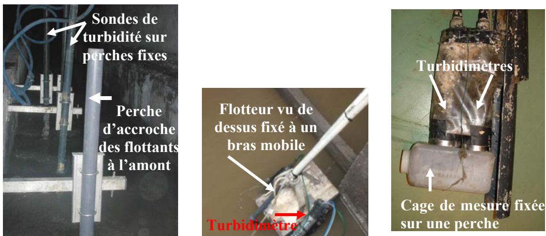
Figure 13 : Systèmes d'installation et de protection des sondes contre les déchets flottants, perche d'accroche (gauche, site des Quais à Paris), flotteur (milieu, site de Maxeville à Nancy), cage de mesure (droite, site de Duchesse Anne à Nantes)
