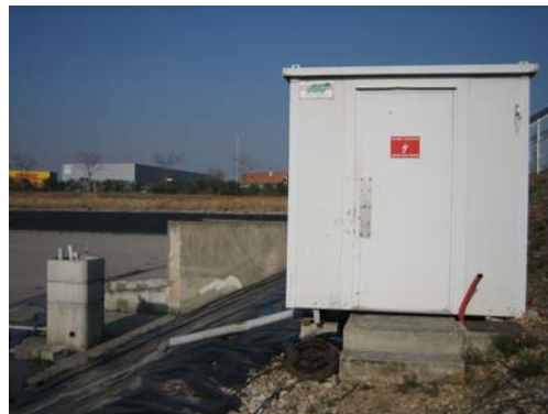
Figure 20 : Accès facilité aux appareils de mesures dans un local technique proche du point de mesure sur le site de Chassieu à Lyon (INSA de Lyon – site de l'OTHU)
