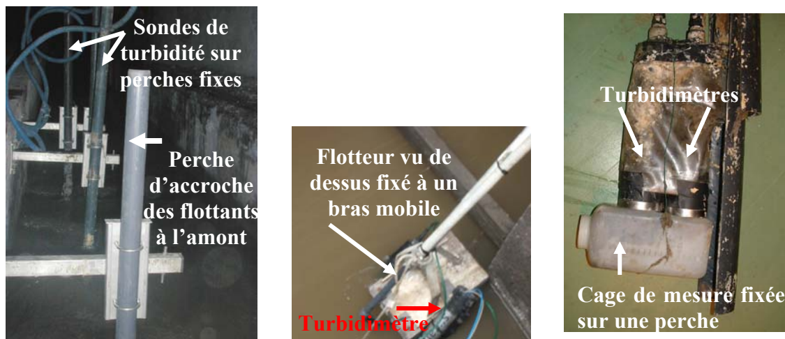
Figure 13 : Systèmes d'installation et de protection des sondes contre les déchets flottants, perche d'accroche (gauche, site des Quais à Paris), flotteur (milieu, site de Maxeville à Nancy), cage de mesure (droite, site de Duchesse Anne à Nantes)
