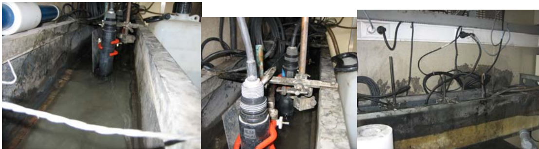
Figure 19 : Mesures en continu en dérivation dans un local technique sur le site de Chassieu à Lyon (INSA de Lyon – site de l'OTHU)
