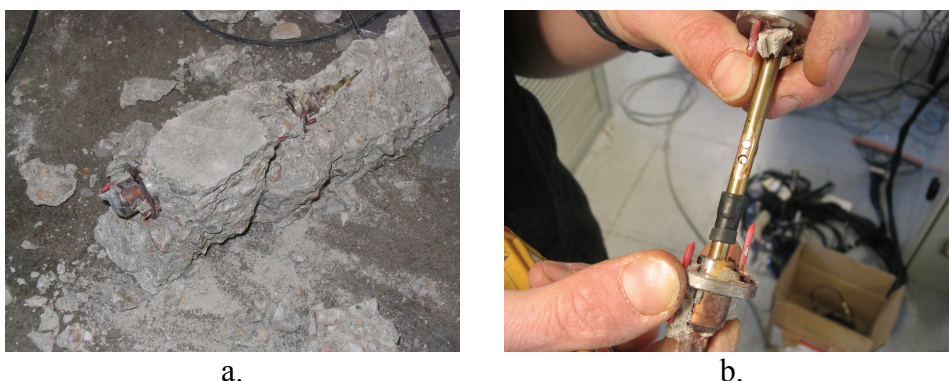
Figure 2-54 : diagnostic du problème des capteurs à corde vibrante après cure thermique (a. récupération du capteur ; b. déplacement d'un aimant)
