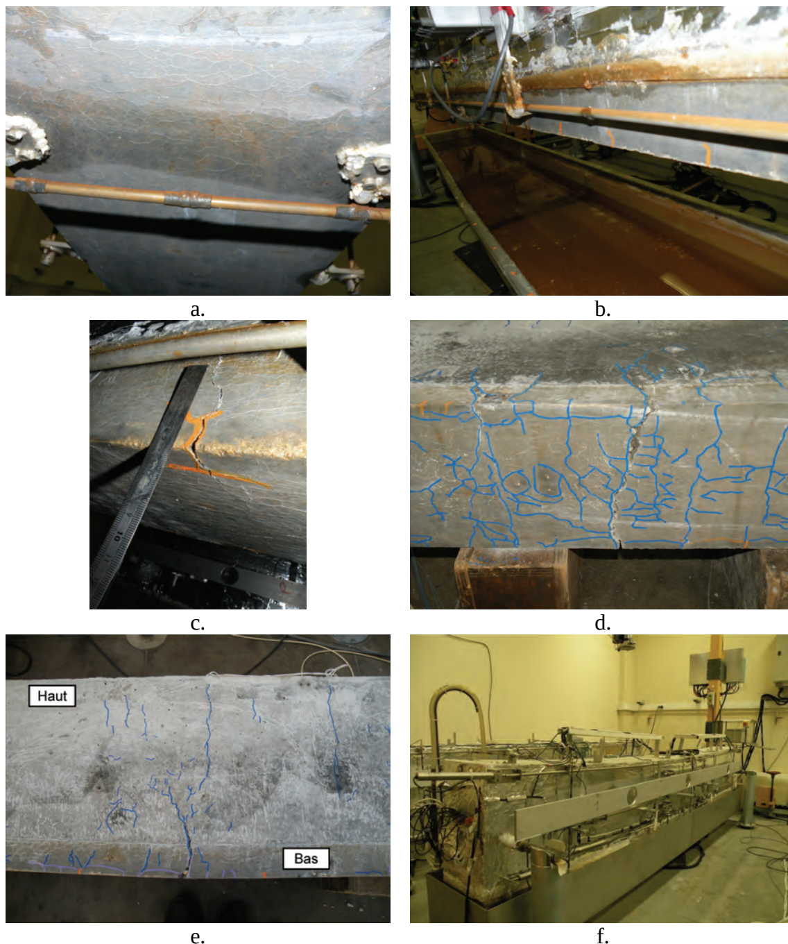
Figure 4-41 : fissuration de la poutre P2
