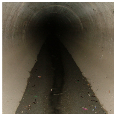
(d) Canalisation de stockage
