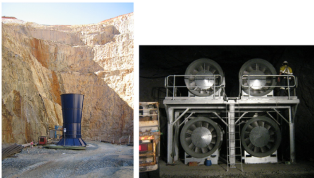
FIGURE 1.2 – Ventilateurs utilisés dans les ouvrages souterrains, ( www.mtvent.com.au ).
